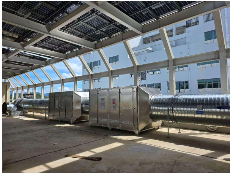
图 2-5 现场废气净化治理设施图
